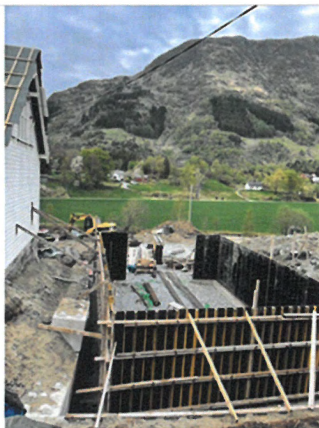
Figur 2 Etter masseutskifting (mer enn planlagt) og komprimering fikk midlertidig støttekonstruksjon en lokal deformasjon. Støttekonstruksjonen bulte ut en god del i toppen. Det var ikke mulig å sette opp midlertidig mur på nytt, da ville eksisterende hus rase delvis ned. Dette gjorde at bygget ikke kunne komme nærmere eksisterende hus. Det ble valgt å flytte tilbygget 0,5 m fra opprinnelig plan. Mellombygget ble da 0,5 meter lengre enn prosjektert.
