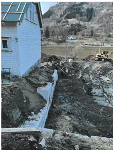
Figur 1 Før deformasjon/ delvis utglidning
