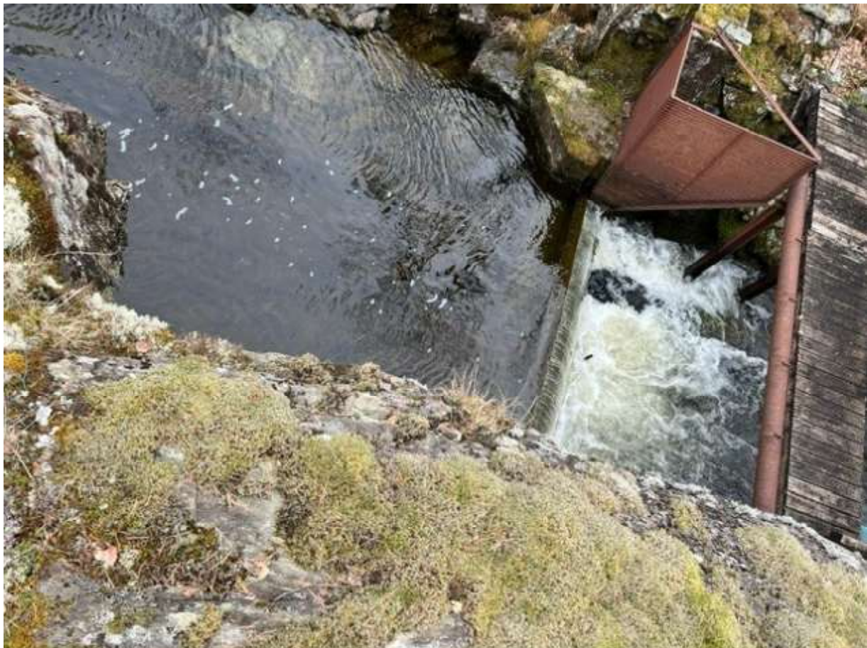
Figur 3. I enden av den utskutte kanalen i figur 2 , er det etablert en dam på 80 cm høyde og vel 2,5 meters bredde. Her var tidligere et oppvandringshinder for anadrom fisk, som i dag er fjernet, og søkes ikke reetablert.
