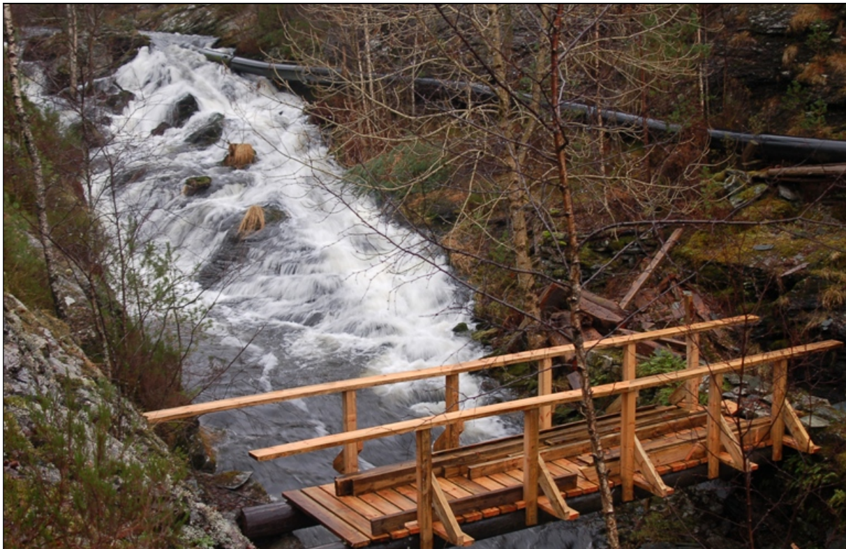
Figur 4. Tilførselsledningen til anlegget ligger delvis i kanten av elven og fra midtveis følger den langs østsiden nedover til anlegget (nederst).
