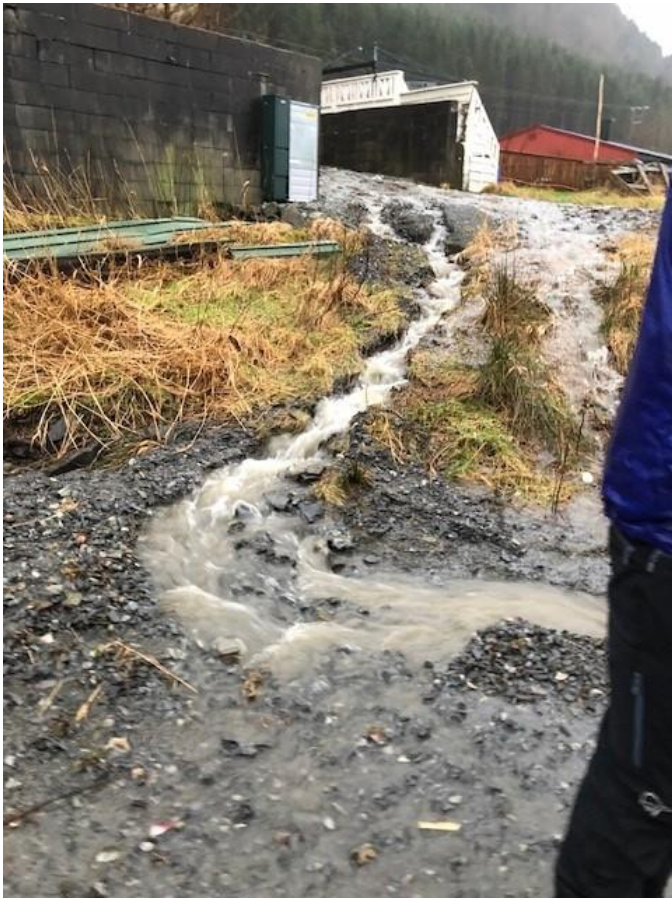
Bilde 1 overvann som renn over Campingplass vegen
