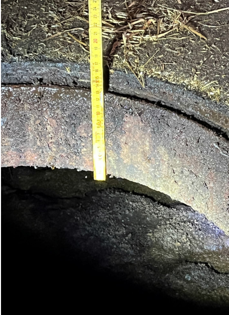
Figur 22 Foto viser tykkelse forbrett av betong
