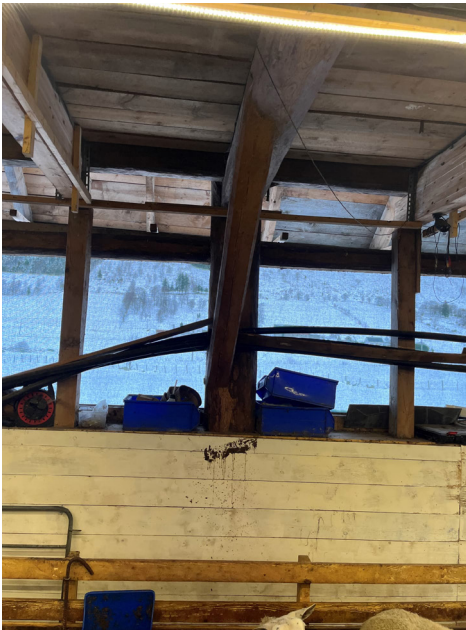
Figur 8 Foto viser to limtrebjelker med søyler, en bjelke på hver side av eksisterende grind
