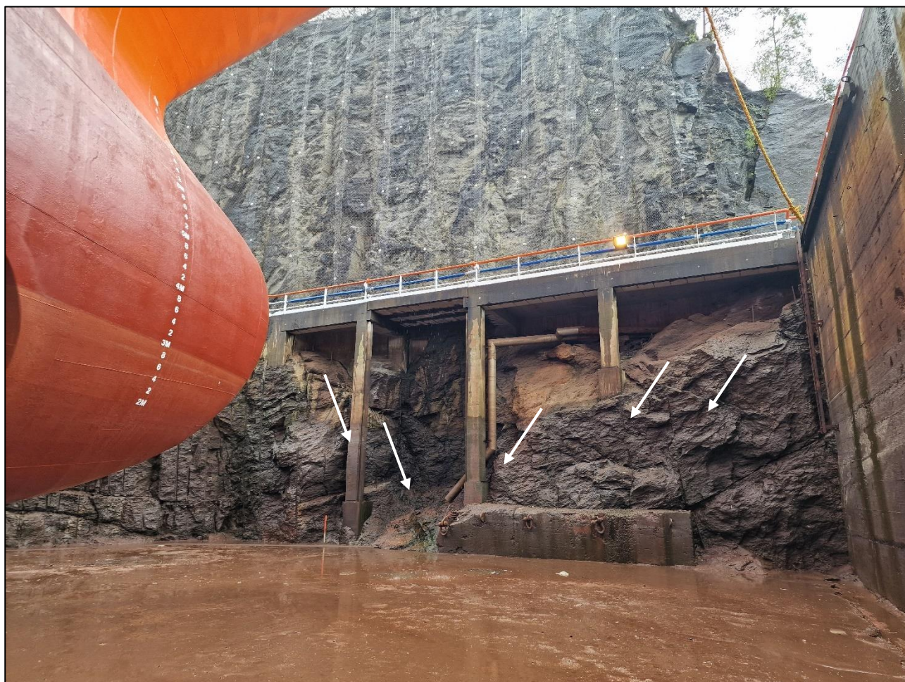
Foto 7: Sprekkesett med fallretning ut av skjæringen og ned mot dokk.
