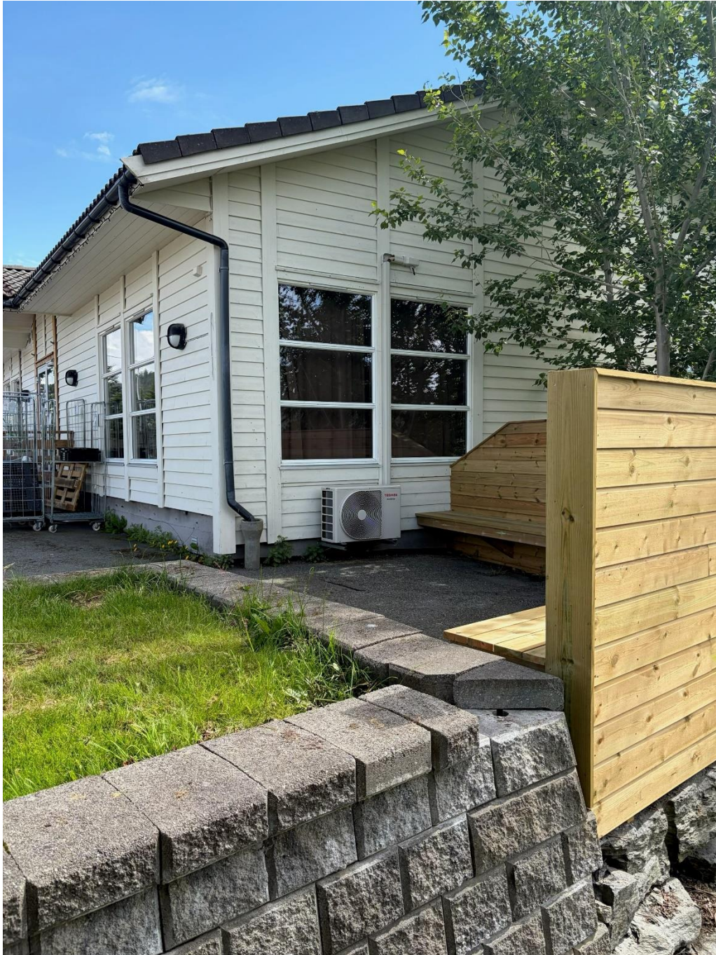
Figur 3 Levegg bygget med benker mot grense som gir for stort skjenkeområde, ikke i tråd med søknad.
