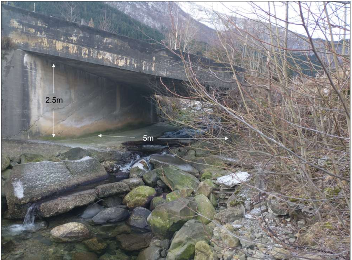
Figur 31 Bildet er tatt hvor Oksareelva føres under Omvikdalsvegen ved kulvert med dimensjon 5 x 2.5 meter. Dimensjonering er tilstrekkelig til å ta unna flomverdier langt over Q200 flomverdier.
