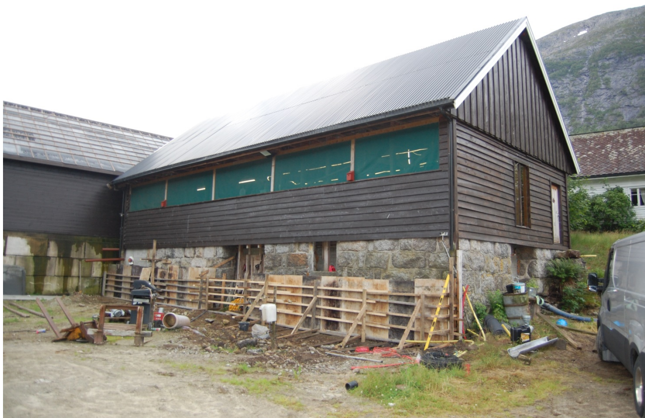
Foto: Bygningen sett frå tunet, ny kledning og ståltak på det eldre bygget. Forskaling i framkant er til opplegg for søyler til kaldtlayer som skal byggast og er del av søknaden om tilbygg som skal byggast. Tilbygg godkjent 2018
