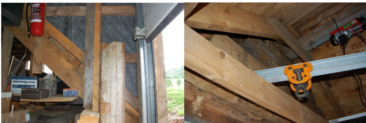
Foto: Stolpe til takoppløft ved låvebru og takkonstruksjon - taksperre og hanebjelke i mønet.
