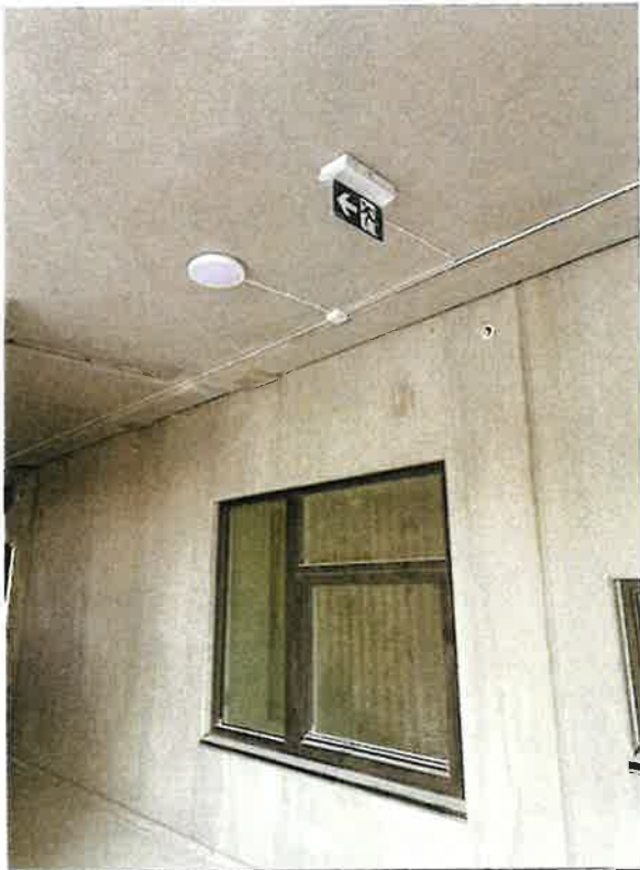
Skilt for rømming. Belysning som er sensorstyrt
